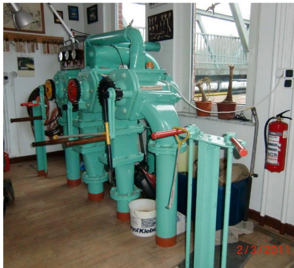
図2: Witzeeze閘門。運転室内の「圧縮空気」「真空」を用いる操作・制御弁は、現在も稼働中 (出典: BAW)
