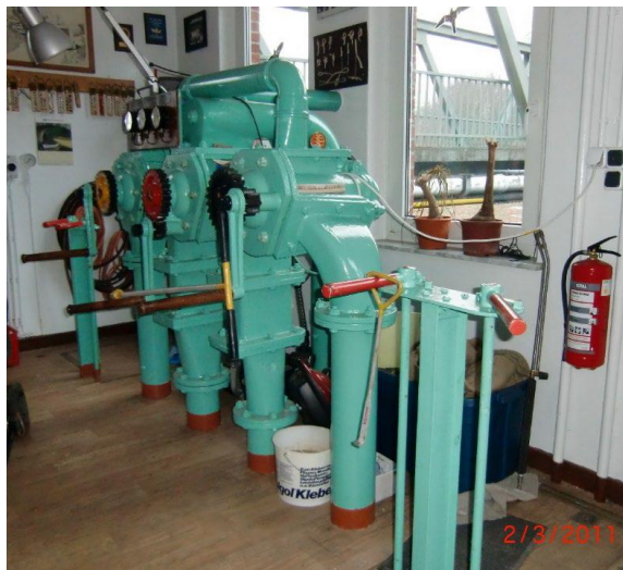
図2: Witzeze閘門。運転室内の「圧縮空気」「真空」を用いる操作・制御弁は、現在も稼働中（出典：BAW）
